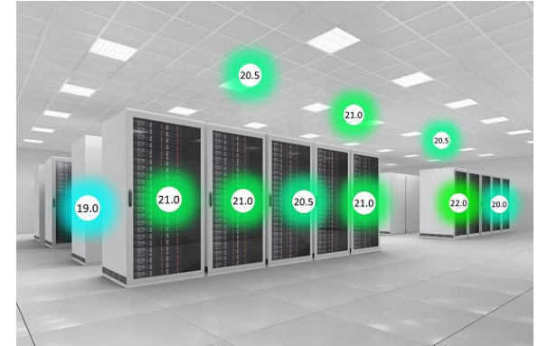
データセンター
