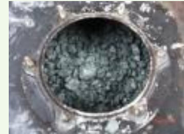
設備の汚れ・錆検出
